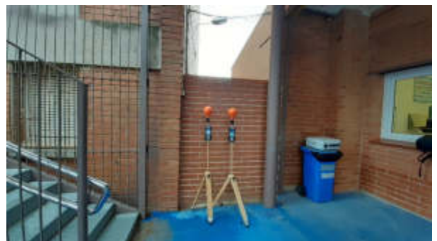
Punt 6: Pati. Al costat de la paret propera al transformador
