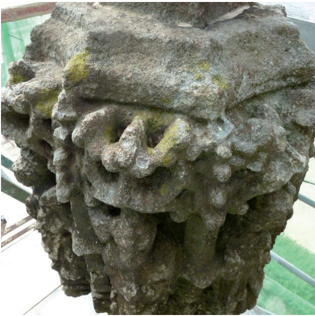
Figura 4. Vista del capitel por la cara Noroeste, más sombría, con presencia de costra y biodeterioro
