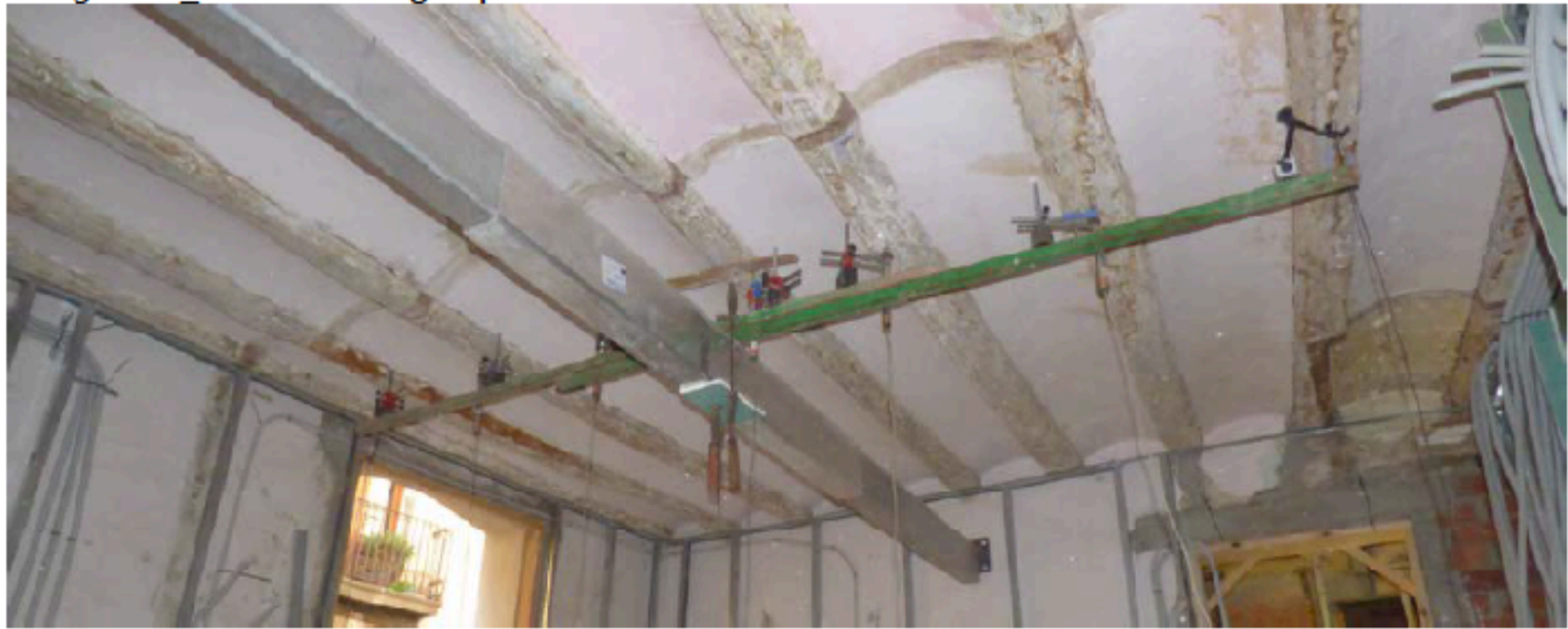
Fotografia 8_ Situació dels extensòmetres
