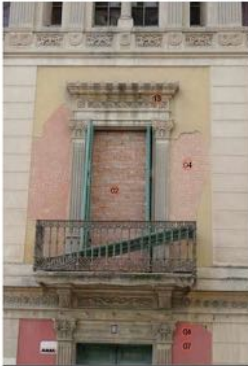
ESTAT ACTUAL RUSTRES TORRE SAGRERA
