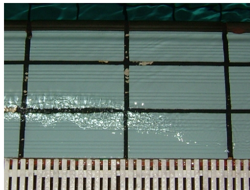
Desbordament de l'aigua del vas
