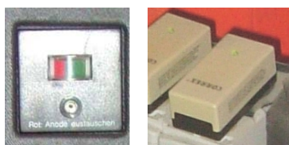
Supervisió funcionament sistema de protecció contra la corrosió
