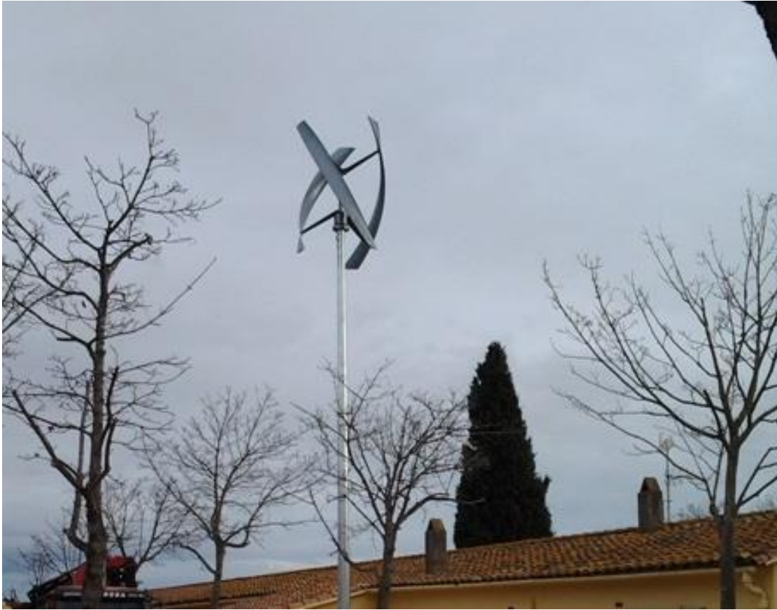
Aerogenerador per autoconsum a l'escola
