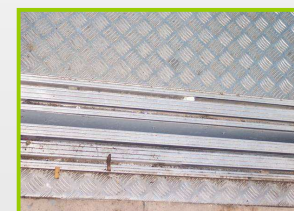
Separació i desnivell entre cabina i replà correctes
