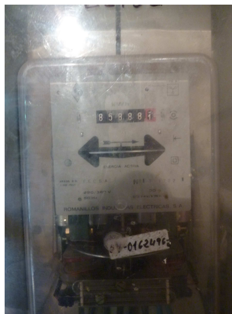
Comptador elèctric general
