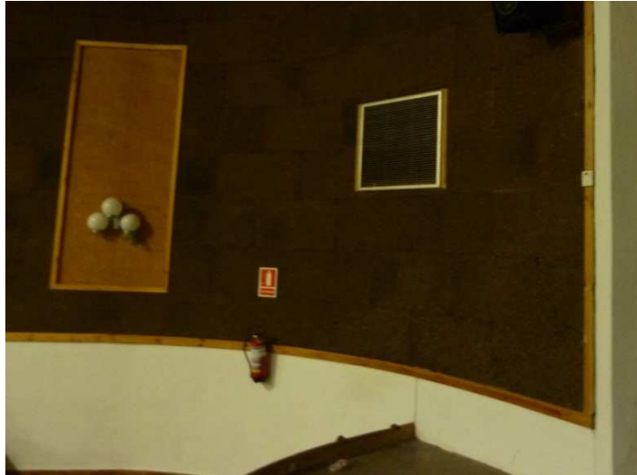
Reixa d'impulsió del climatitzador a la sala
