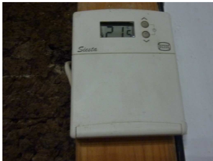
Termòstat de la sala
