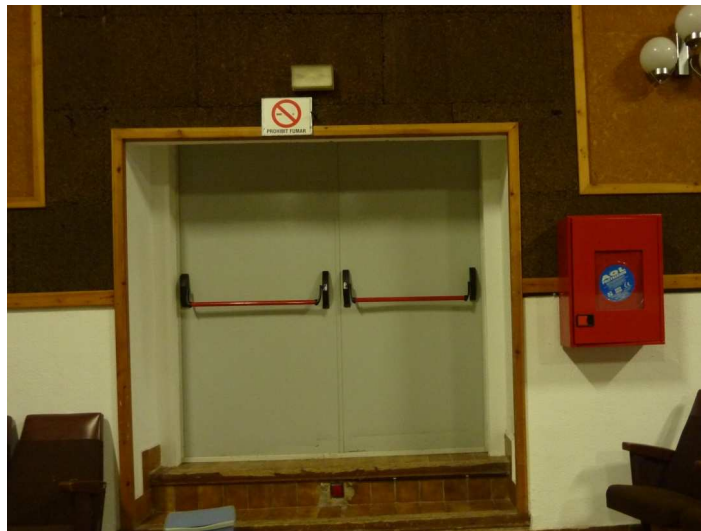
Enllumenat d'emergència situat sobre les portes
