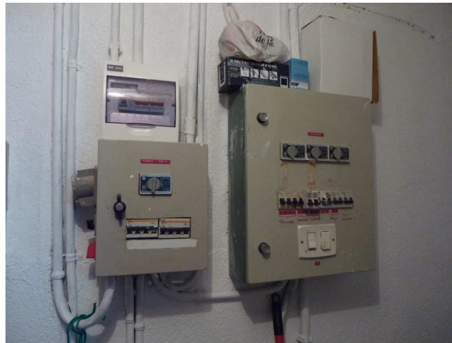
Quadres elèctrics amb proteccions fora de normativa
